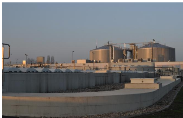
Fotografia IV.1.1. Oczyszczalnia ścieków Pomorzany (źródło: ZWIK, WIOŚ Szczecin)
